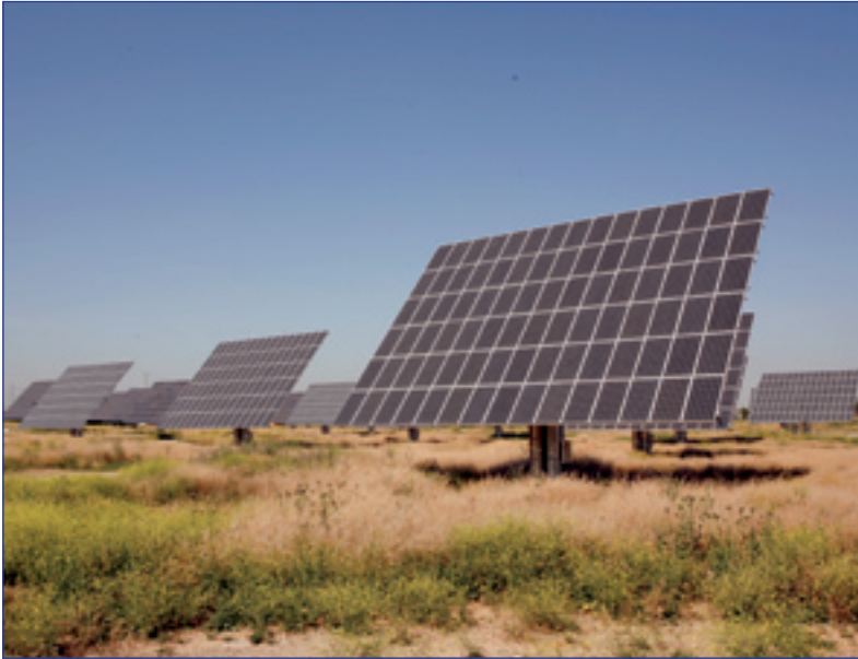
Planta solar de Copero
